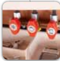
Zentraler Gasverteiler in der Küche
